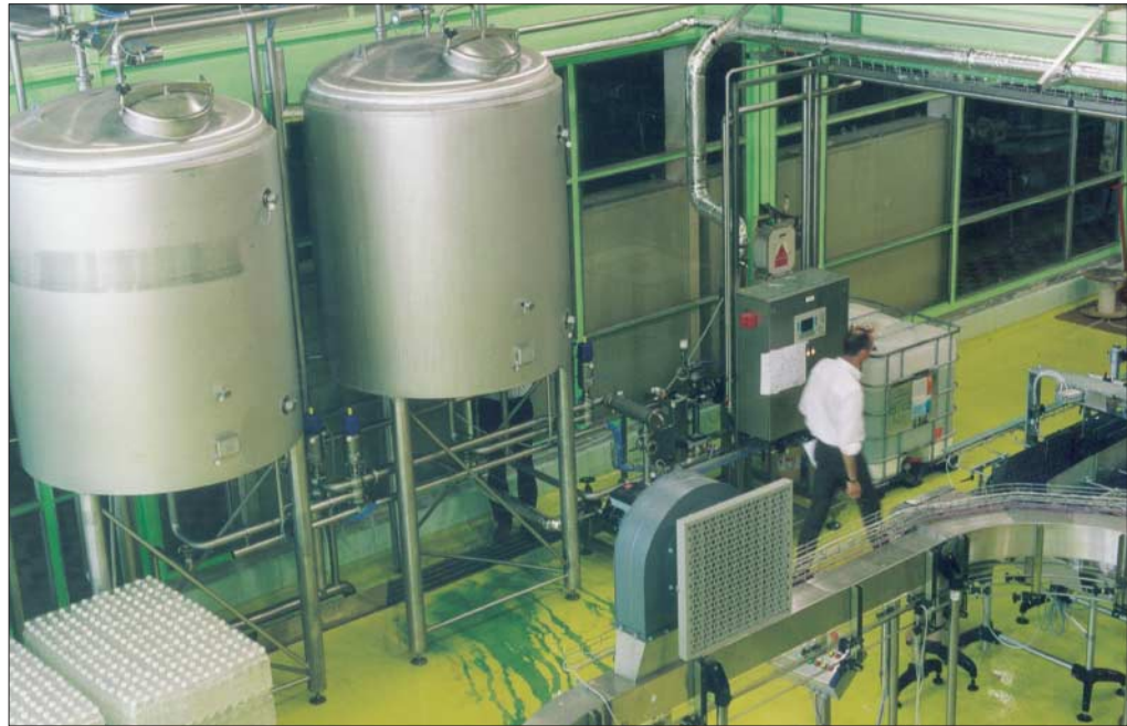
Frischansatz CIP-Anlage mit zwei Stapelbehältern für Lauge und Nachspülwasser, mit Transportschaden: Scheuernder Spanngurt und Inbetriebnahmeschaden: Lauge auf Fußboden.
